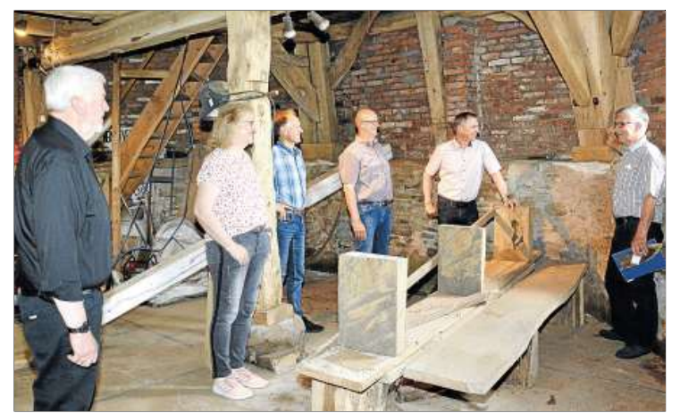
Informationen über die Restaurierungsarbeiten gab der Vorsitzende des Essener Heimatvereins, Karl-Heinz Schnieder (rechts), den Gästen aus der Politik. Foto: Sperveslage
